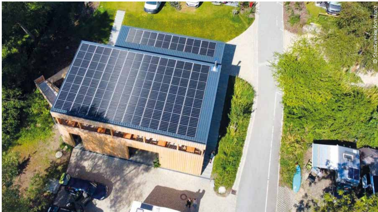
Eine der neuen Photovoltaik-Anlagen 2021 wurde auf dem Campingplatz Litzelstetten in Betrieb genommen.
